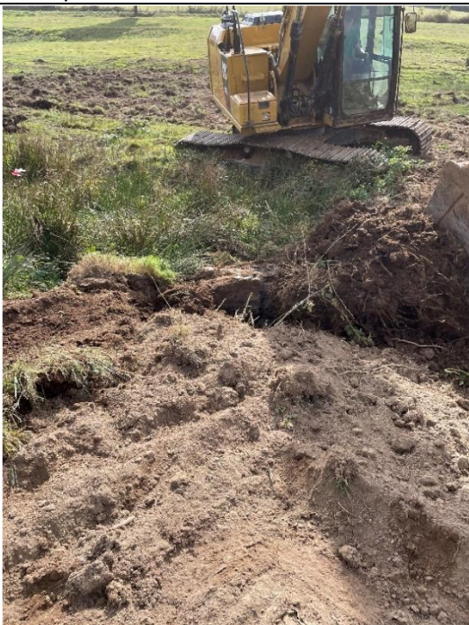
Installation d'un gros bloc de pierre en fond de fossé afin de faire freiner l'écoulement souterrain.
